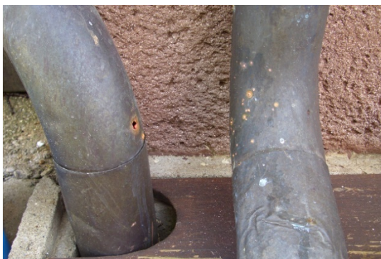
Bild 1 Schmelzwirkungen infolge einer Blitzstromekopplung bei einer Kupferregenrinne. Am Nachbarrohr sind deutlich die Schmelzperlen zu sehen (Brandgefahr). Quelle: OÖ Blitzschutzgesellschaft
