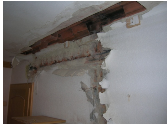
Bild 4 Blitzspuren in einem Objekt ohne Blitzschutzsystem mit nachhaltigen Schäden an der Baustruktur und Folgen für die Statik. Bei diesem Fall wurden 2 Personen durch Mauerbruchstücke schwer verletzt. Quelle: OÖ Blitzschutzgesellschaft
