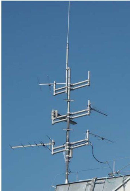
Bild 2 Antenneschutz mit einer HVI-Leitung im Bereich der Antenne mit beidseitigen Endverschluss. Im unteren Bereich ist der Anschluss an die Konventionelle aufgeständert verlegte Fangeinrichtung ersichtlich
