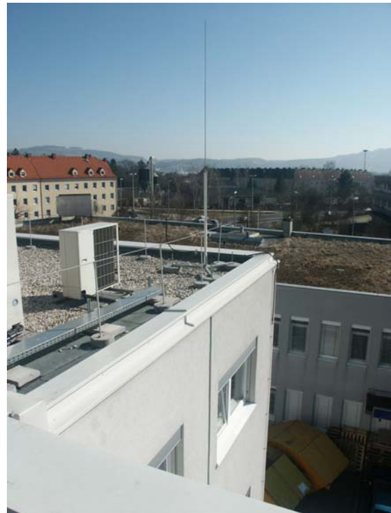
Bild 3 Es ist die Anordnung der getrennten Fangeinrichtungen unter Einhaltung des erforderlichen Sicherheitsabstandes deutlich zu entnehmen. Die im Schutzbereich liegende Attikaverblechung wird durch die Anwendung einer HVI-Verbindungsleitung von direkten Blitzstromeinkopplungen geschützt.
